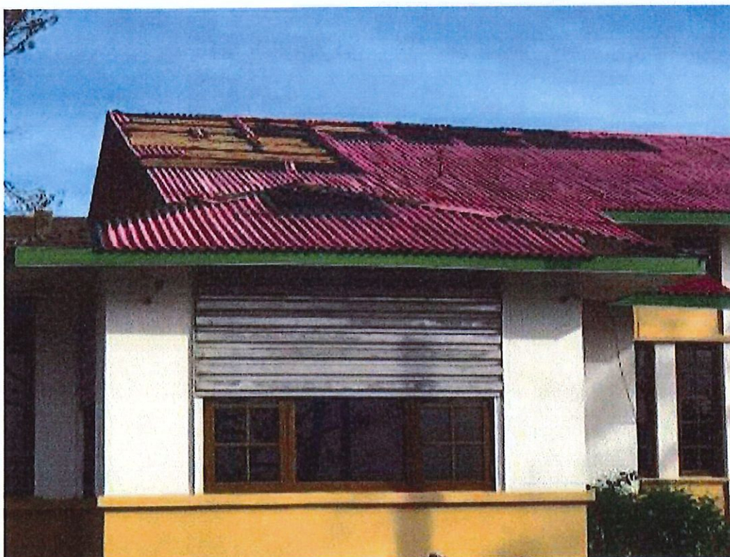
Foto 2: Porción de techo dañado por los vientos huracanados de María en Septiembre 2017.
